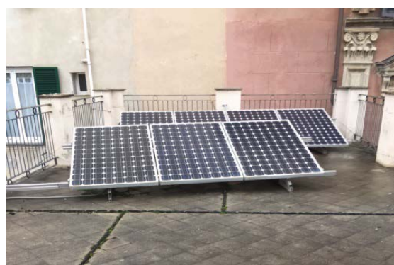
Figura 4.16 - Vista dell'impianto fotovoltaico
