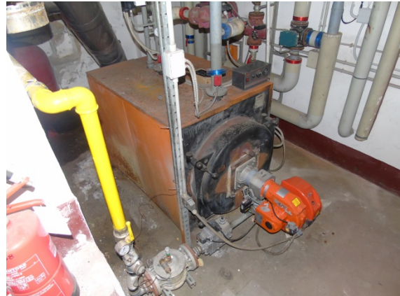
Figura 8.3 – Particolare sistema di generazione obsoleto da sostituire
