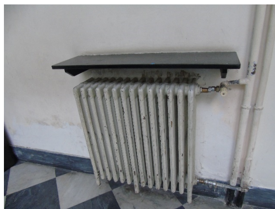
Figura 4.6 - Particolare sistema di emissione
