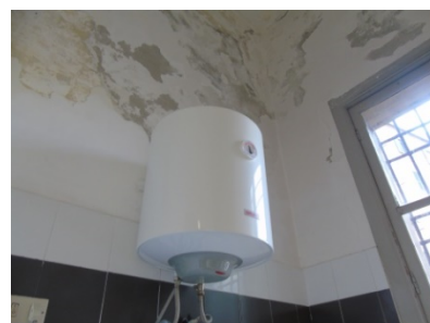
Figura 4.13 – Particolare bollitore elettrico.
