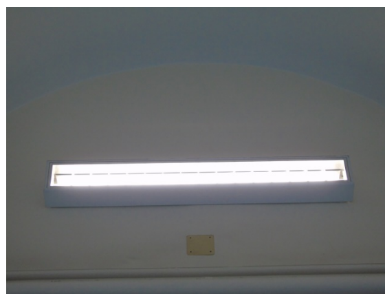
Figura 8.5 - Particolare impianto illuminazione su cui intervenire.
